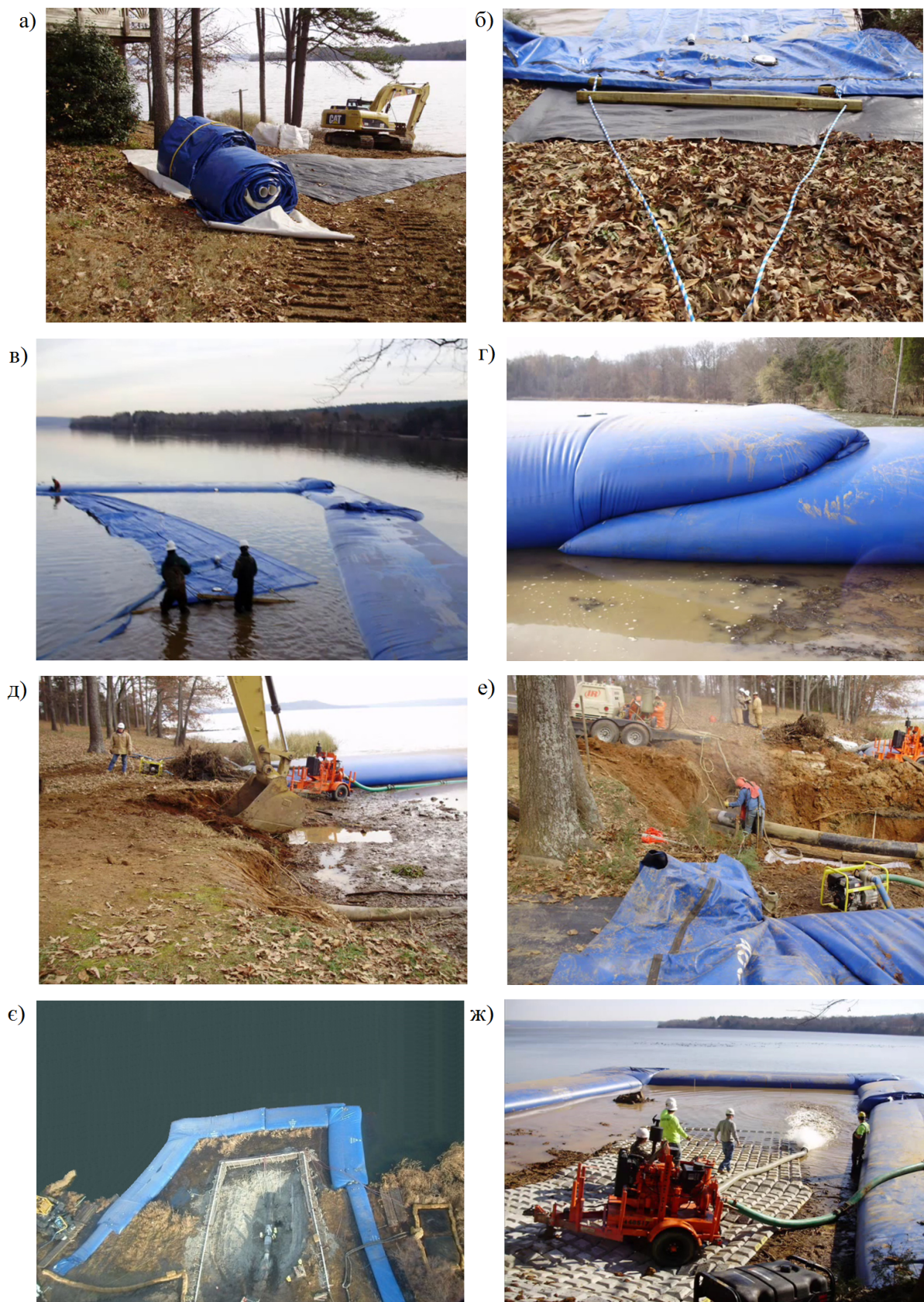
а) – доставлена до місця монтажу система Aqua-Barrier в рулонах; б) – прикріплені до підйімальної петлі канати; в) – розкладання за периметром робочого простору системи Aqua-Barrier; г) – з'єднання секцій системи Aqua-Barrier; д) – розкопування дефектної ділянки трубопроводу; е), е) – ремонт трубопроводу; ж) – заповнення робочого простору водою
