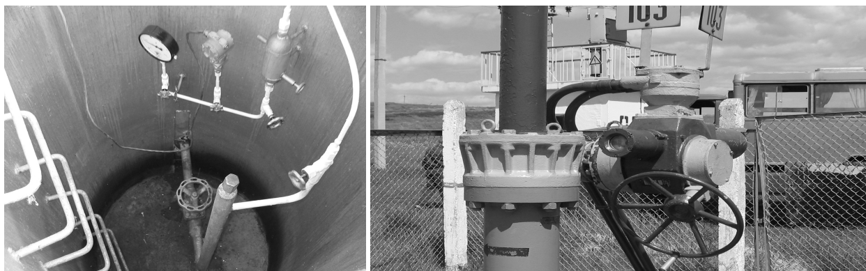
Рисунок 2 – Контрольний пункт системи телемеханіки на 986 км нафтопроводу
