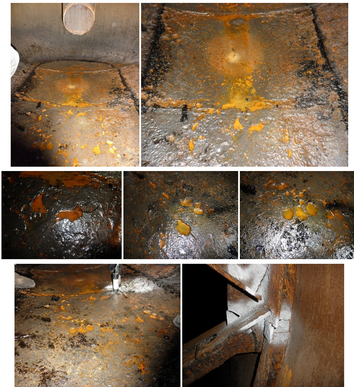
Рисунок 3 – Дефекти, виявлені при технічному огляді буферної ємності ПЕ 200-16 ГС
