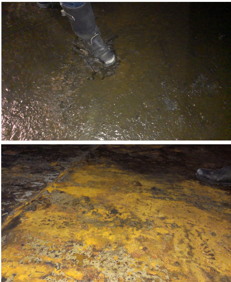
Рисунок 8 – Корозійне пошкодження днища резервуара РВС 1000 №1
