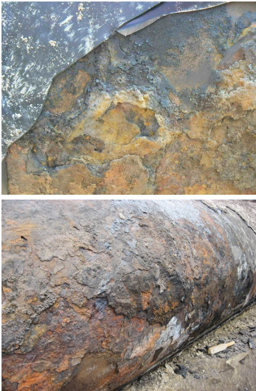
Рисунок 1 – Дефекти бітумної ізоляції
