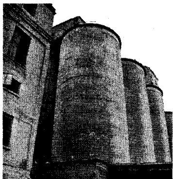
Рис. 1.10. На поверхні силосних банок чітко простежуються шви ярусів бетонування
