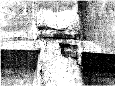
Рис. 3.39. Руйнування торкрету, оголення та корозія закладних деталей вертикального стику ребристих плит другого ярусу
