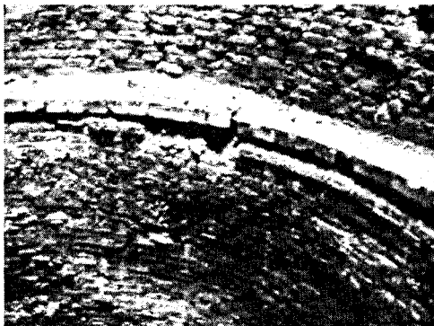
Рис. 1.7. Западини на внутрішній поверхні футерівки труби, руйнування її поверхні та сльозника
