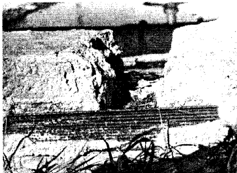
Рис. 1.17. Непроєктний отвір у борті резервуару для зменшення навантаження від водяного екрана на поверхні першого контуру плит покриття
