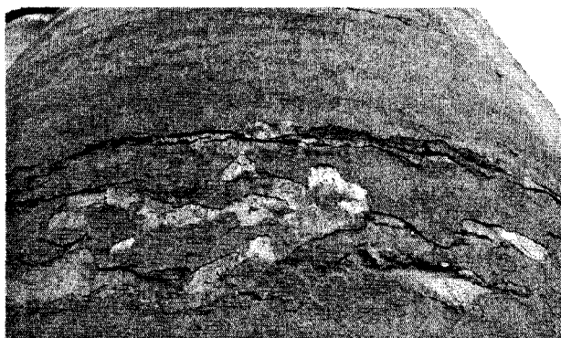
Рис. 1.11. Відшарування захисного шару бетону з оголенням та корозією арматури на поверхні силосних банок. Особливо по швах ярусів бетонування
