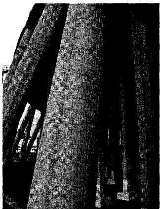
Рис. 1.1. Колони нахиленої колони градири. Відсутність захисного шару бетону. Поздовжні та поперечні тріщини після теплового оброблення пропарюванням
