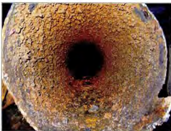
Рис. 3.8. Зношеність водопровідної труби як чинник вторинного забруднення питної води [3]
