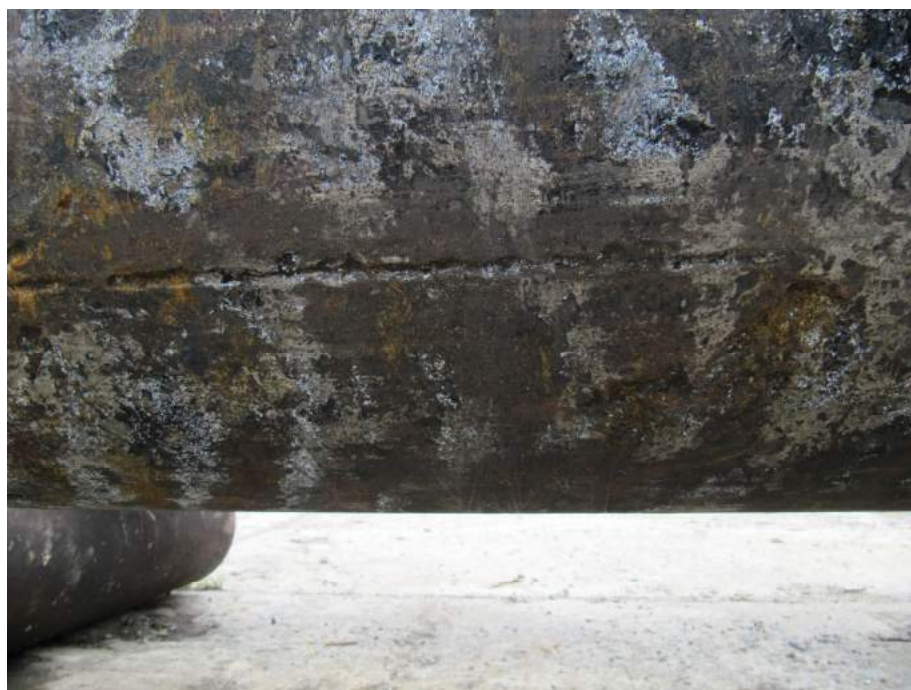
Рисунок 7.9 – Дефектна ділянка трубопроводу діаметром 530 мм
