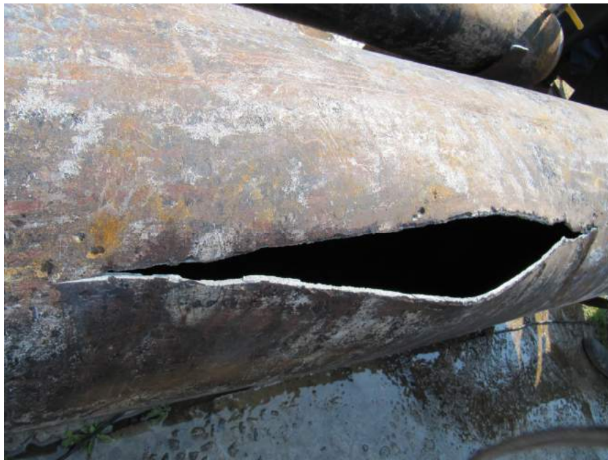
Рисунок 7.11 – Зона руйнування дефектної ділянки трубопроводу
