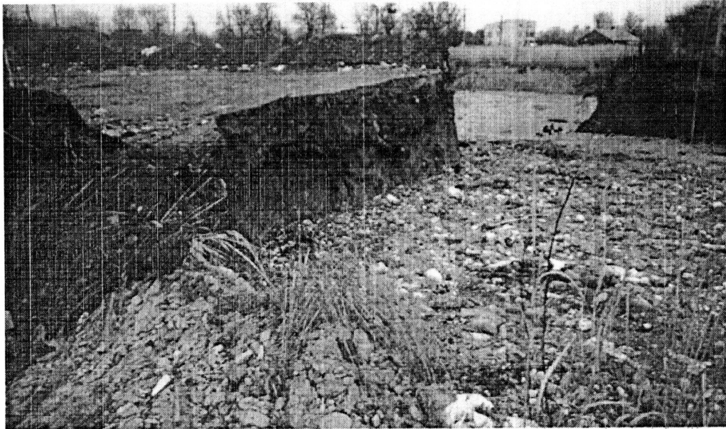
Рис. 2.5. Провал на вул. Глібова у м. Калуш
