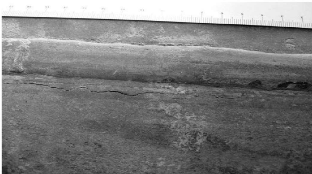
Рисунок 1 - Повздовжній дефект стрес-корозійного характеру на трубі магістрального газопроводу “Уренгой – Помари – Ужгород” діаметром 1420 мм (3871,81 км, діляниця КС “Іллінці” – КС “Бар”) [95]
