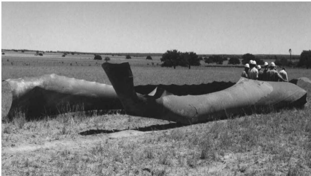
Рисунок 1.2 – Руйнування газопроводу (610×7,3 мм) [129]
