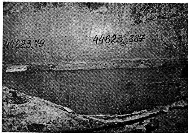
Рисунок 2.7 – Дефекти основного металу зварного з'єднання трубопроводу [72]
