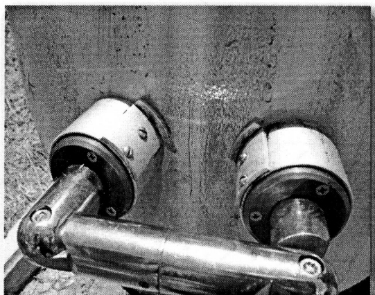
Рисунок 4.28 – Вигляд тріщини після проведення магнетопорошкової дефектоскопії (зліва і справа від тріщини – магнетні наконечники приладу)
