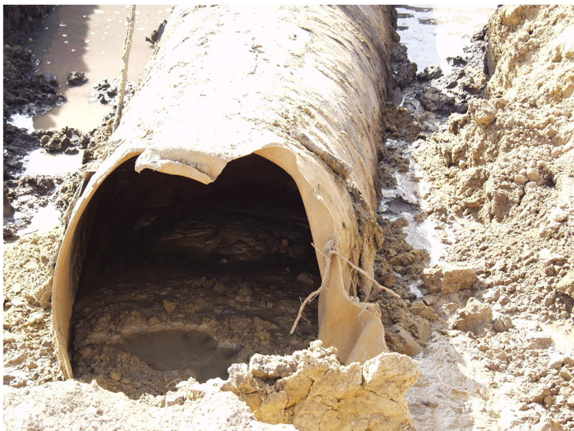
Рисунок 1.3 – Фрагмент аварії на газопроводі «Новопсков – Акай – Моздок»
