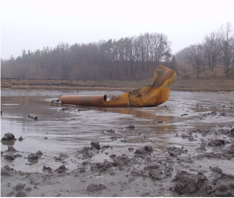
Рисунок 2.2 – Лавинне руйнування магістрального газопровода УПУ зі сталі 17Г1С, довжина руйнування складає 373 м
