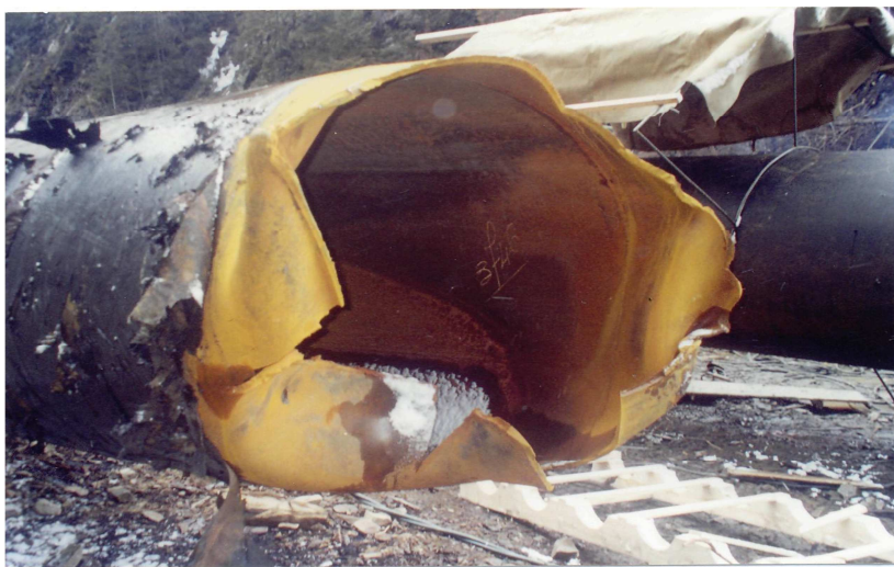
Рисунок 1.4 - Фрагмент магістрального газопроводу «Союз» після вибуху газу (Карпати, 07.03.2001 р.)
