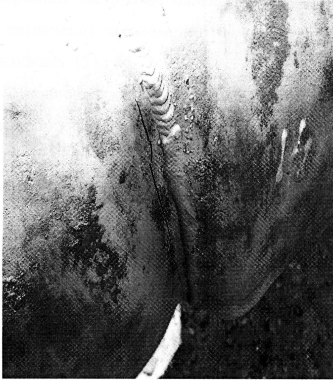
Рис. 1.3 Тріщина біля монтажнього кільцевого шва
