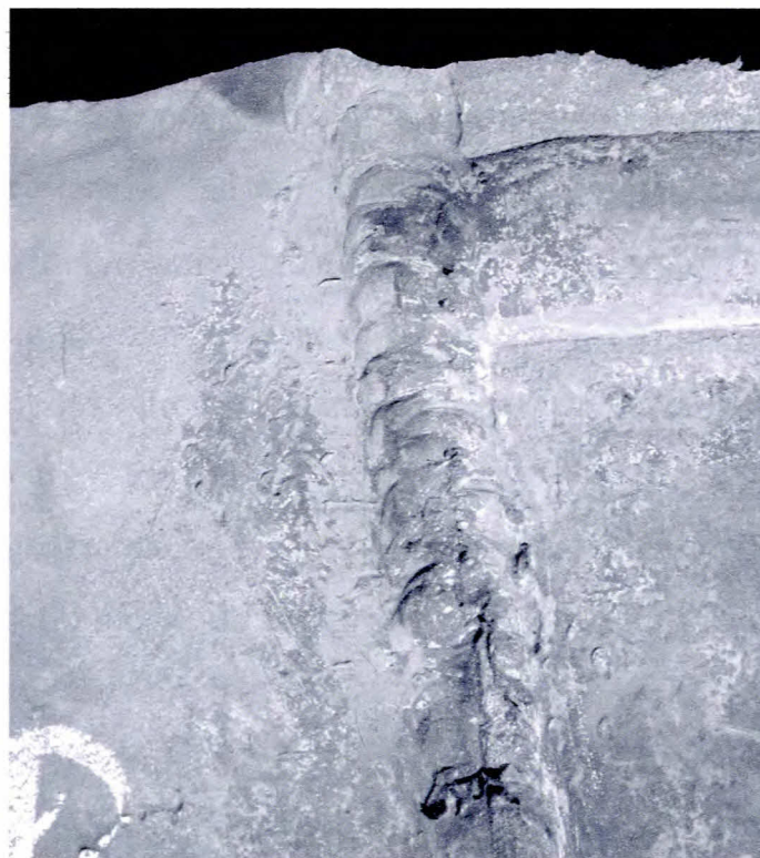
Рис. 1.2. Дефекти в околі кільцевого зварного шва трубопроводу
