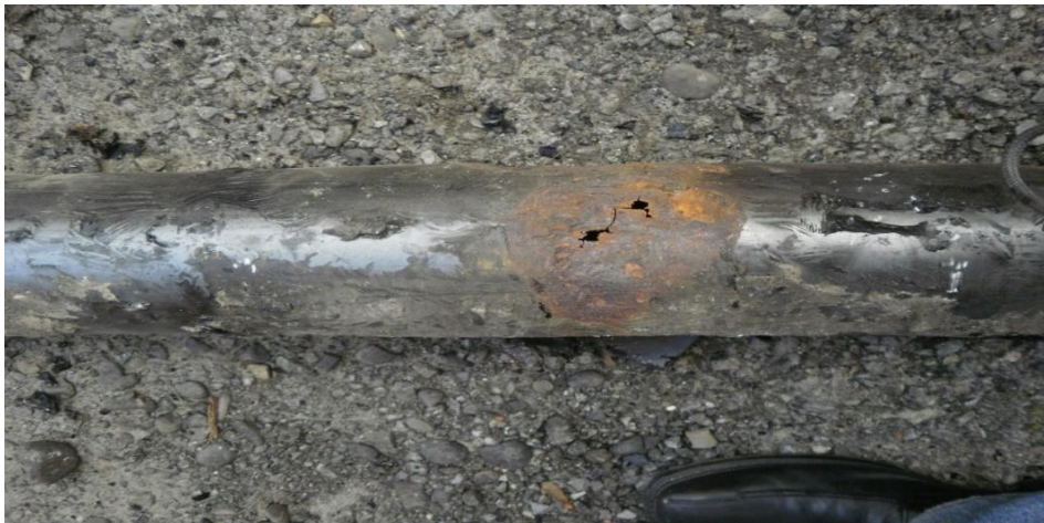
Рисунок 1.4 - Отвори газопроводу, утворені витокком газу в с.Світанок по вул.Зелена
