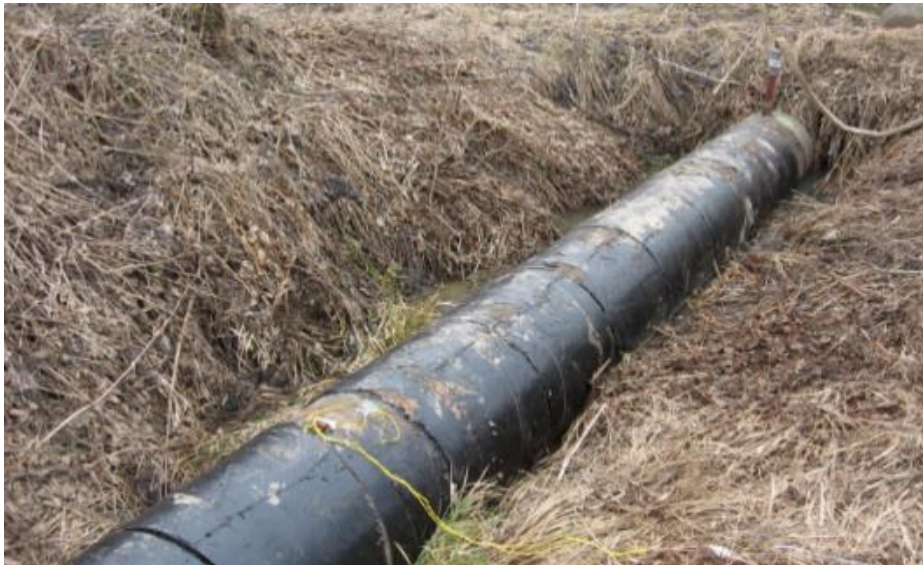
Рисунок 4.1 – Загальний вигляд труби для гідравлічних випробувань
