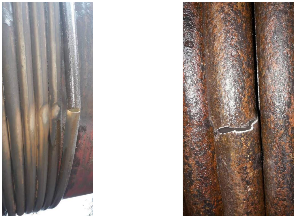
Рисунок 1.4 – Втомні тріщини через перевищення дозволеного напруцювання ГТ [49]
