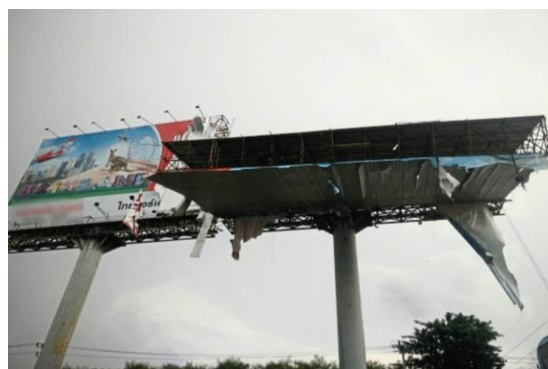
Рисунок 8 – Зруйнована верхня частина білборда
