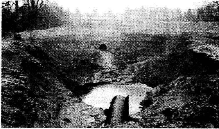
Рис.1.2. Розрив магістрального газопроводу, спричинений зменшенням товщини стінки
