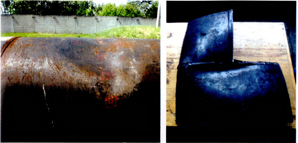
Рисунок 4.2 – Фрагменти трубопроводу з вм'ятиною
