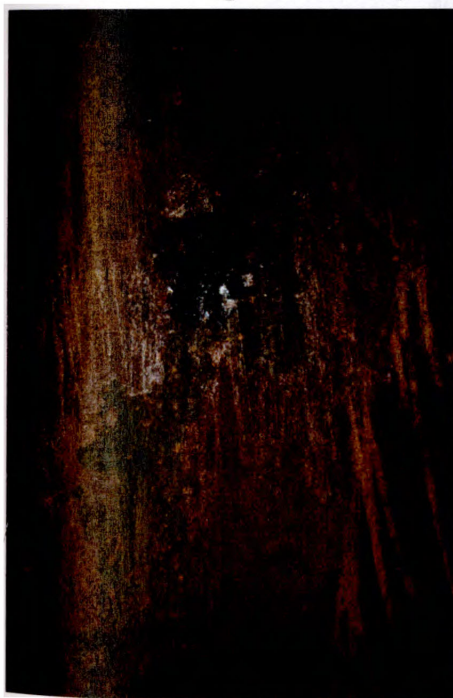
Рисунок 2.7 – Внутрішня поверхня труби взята з аварійного запасу газопроводу «Івацевичі-Долина»
