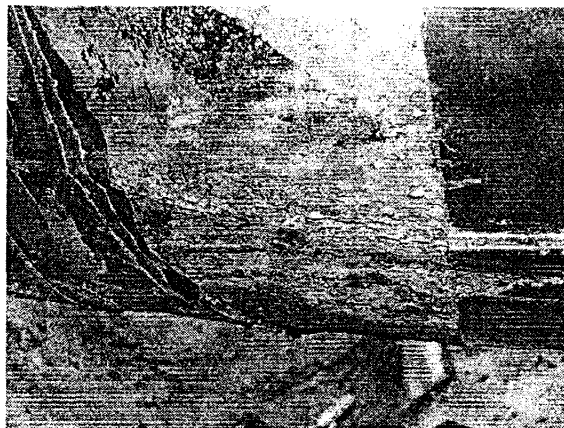
б) відшарування ізоляційного покриття
