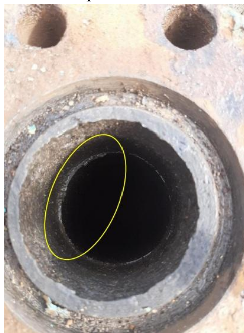
Рисунок 7.9 – Виступ у порожнину трубопроводу у місці зварного шва шлейфа свердловини
