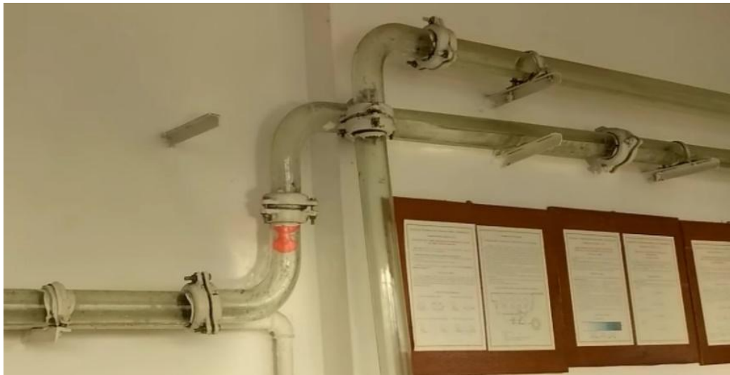
Рисунок 3.27 – Тимчасова зупинка гантелеподібного трикулевого очисного поршня з силіконового компаунда в місці виступу гумового ущільнення з'єднання скляних труб в порожнину трубопроводу
