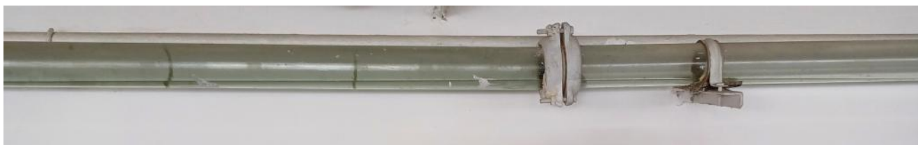
Рисунок 3.23 – Залишок води в горизонтальній ділянці трубопроводу після проходження очисного поршня
