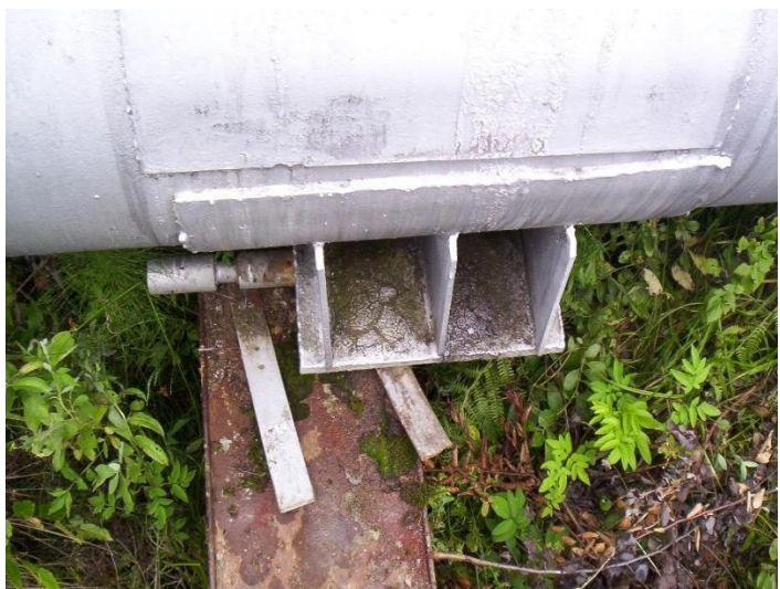
Рисунок 5.9 – Руйнування опорних вузлів
