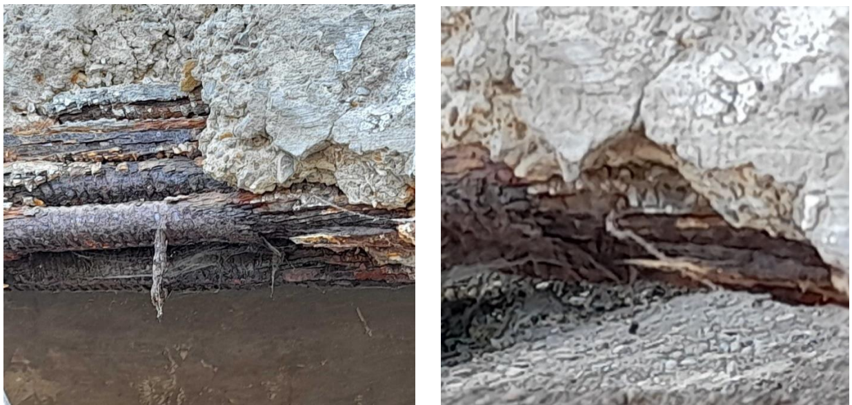
Рисунок 5.18 – Руйнування арматури залізобетонного елемента внаслідок тривалого кородування
