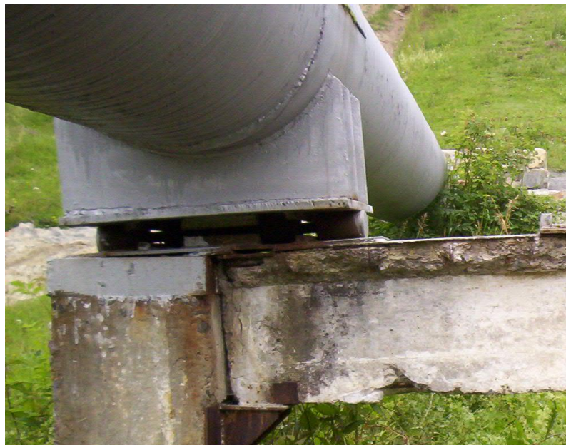
Рисунок 2.4 – Загальний вигляд опорного вузла нафтопроводу D = 720 мм з обпиранням столика на стояк і ригель
