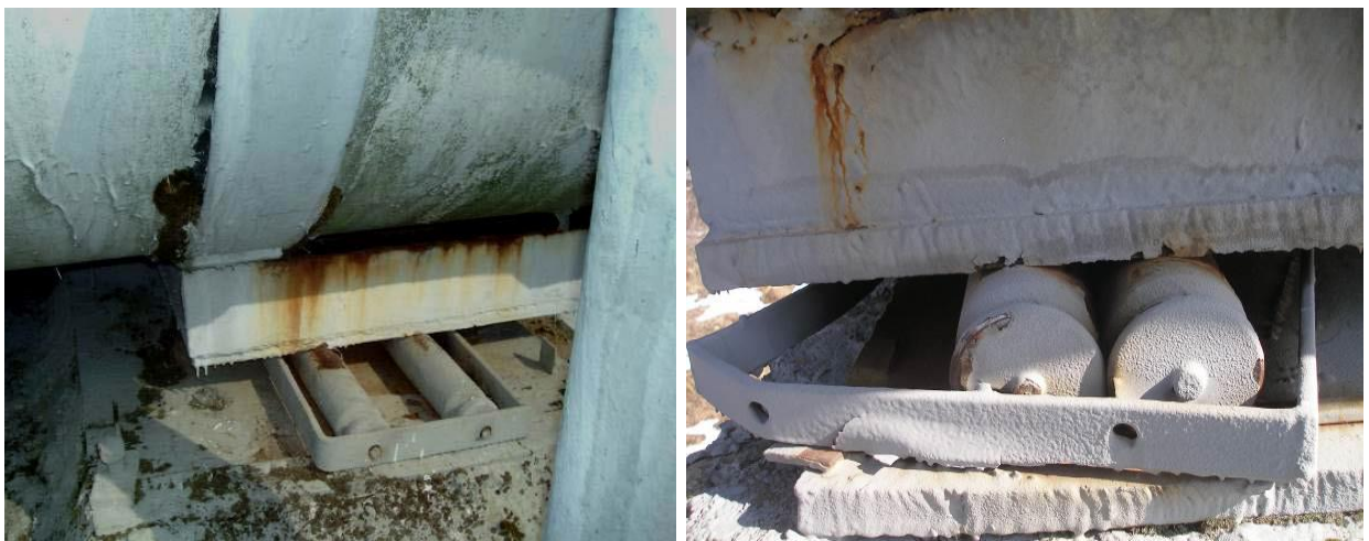
Рисунок 5.15 – Руйнування в перерізі труба – опорна частина [34]
