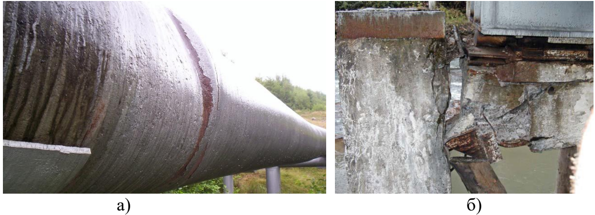
Рисунок 1.10 – Дефекти надземної ділянки: а) пластичне деформування трубопроводу; б) руйнування ригеля опори трубопроводу [71]
