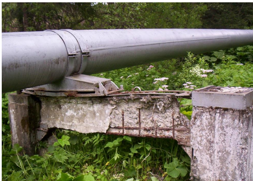
Рисунок 4.17 – Руїнування залізобетонного опорного елемента
