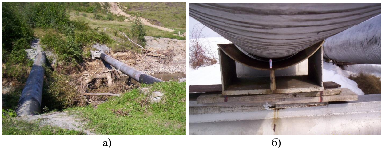
Рисунок 5.16 – Руйнування утримувальних опорних елементів: а) розмивання берегової лінії; б) зазор між трубопроводом і опорою
